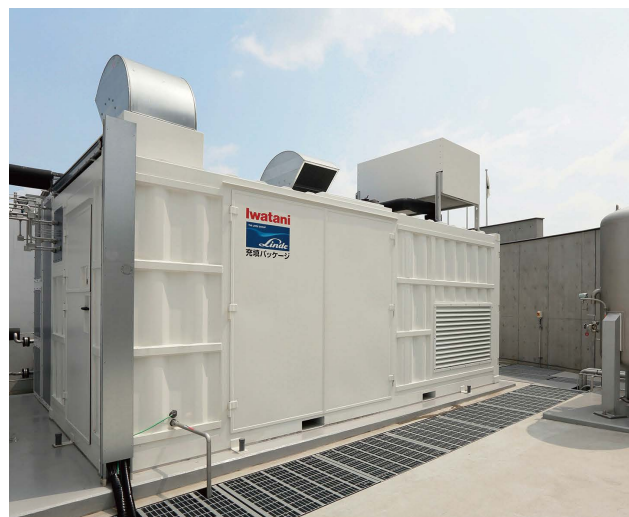
水素ステーション
