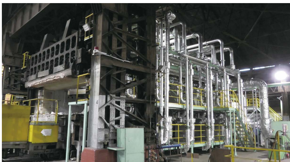
圧延工場 加熱 3 号炉外観写真（更新後）
