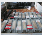
安定器等 (増設施設にて)
