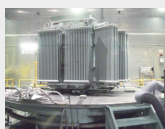
高圧トランス (当初施設にて)
