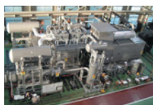
コンプレッサー
