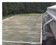
生物脱臭装置
