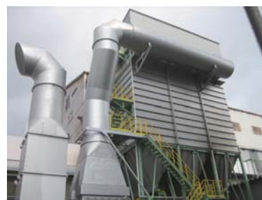
新規導入設備 (鍛練工場ガウジング加工場・ 研削場集塵機)
