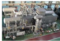
コンプレッサー
