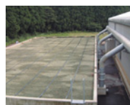
生物脱臭装置
