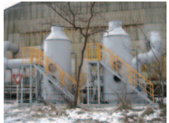
新規導入設備 (メッキ工場排気処理装置)
