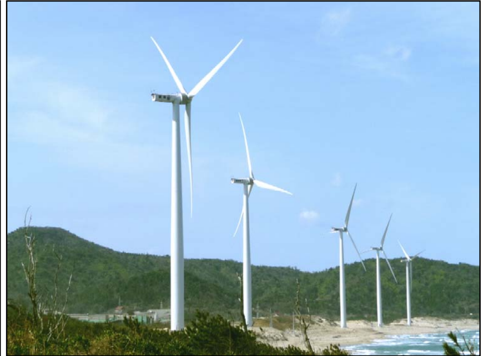
島根県江津市に設置した風力発電機J82(11基)
