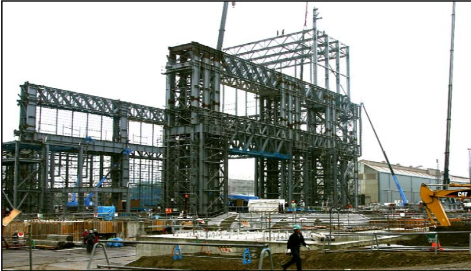
鋼塊製造効率向上のため、製鋼工場建屋を延伸 (基礎工事を終え、建屋建設作業に取り掛かる)
